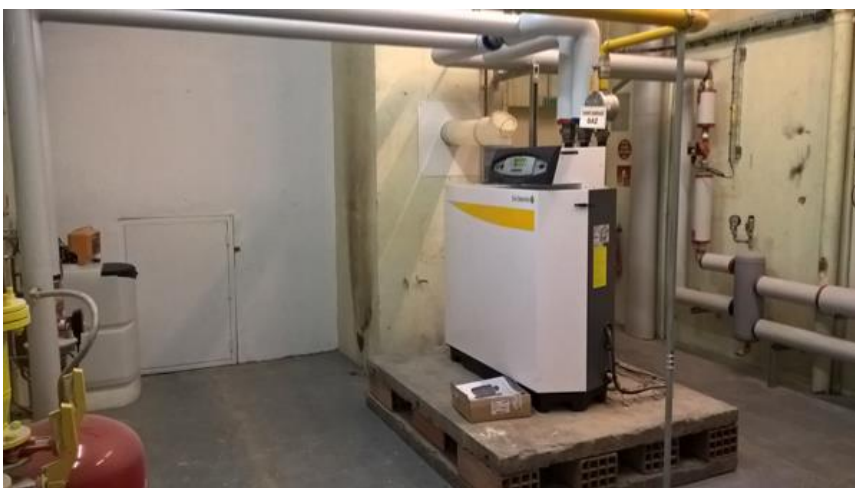
Nouvelle chaudière assurant le chauffage du RDC (bureau de Poste + Centre Courrier) : puissance 179 kW.
