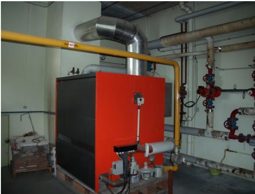
Ancienne chaudière assurant le chauffage de tout l'immeuble (910 m 2 ) : puissance 355 kW
